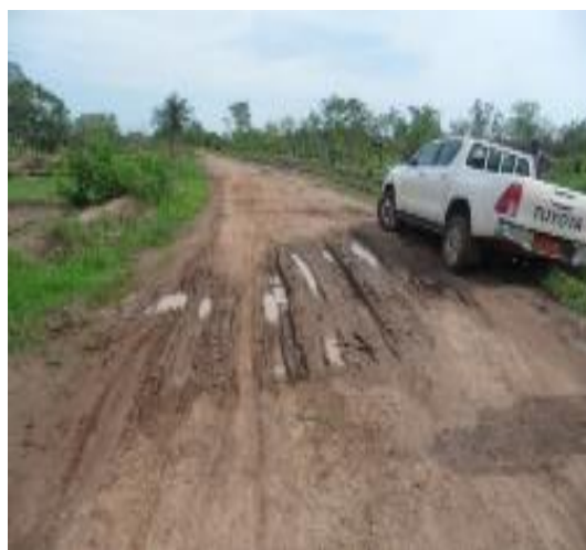
Bourbier sur la chaussée rendant la circulation difficile
